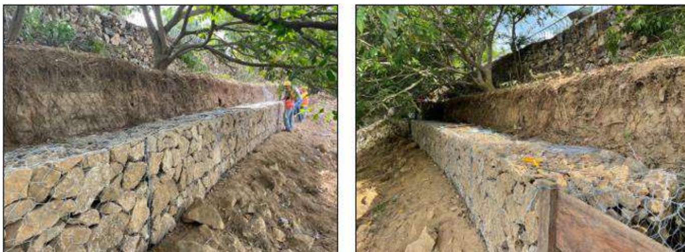
Ilustración 275. Control de erosión ronda norte Montería. Fuente: CVS, 2023
