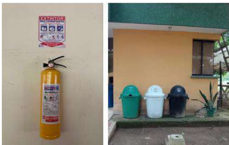
Ilustración 232. Instalación y ubicación de extintor y punto ecológico en la Estación Piscícola. Fuente: CVS, 2023
