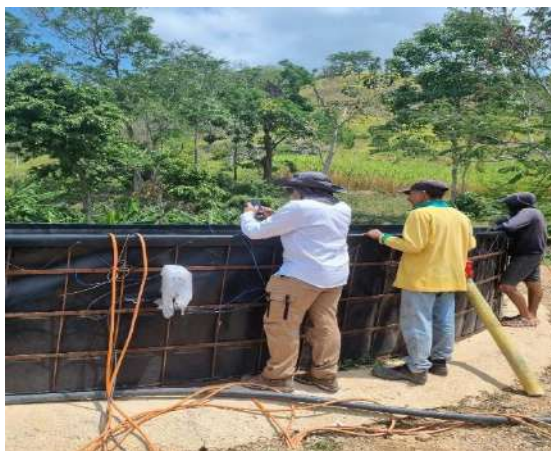
Ilustración 35. Seguimiento PUEAA aprobado Estación Piscícola Chinú. Fuente: Equipo SGA, 2023
