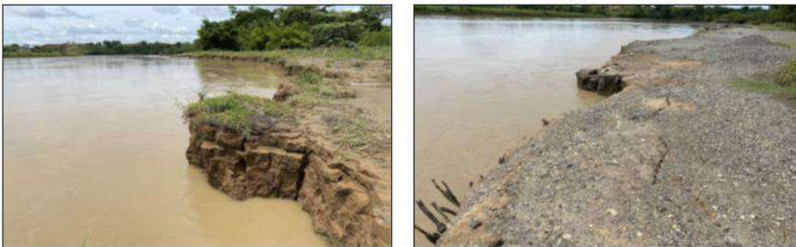
Ilustración 148. Registro fotográfico del punto crítico “Bocas de Uré” ubicado en el municipio de San José de Uré. Se observa agrietamiento en el talud en la margen derecha del río San Jorge. Fuente: Grupo de Gestión del Riesgo – GGR CVS, 2023.
